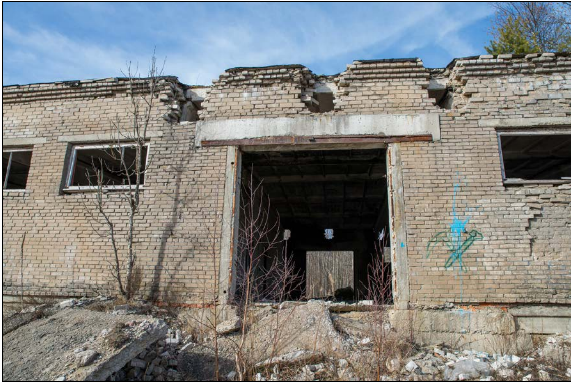
Foto 3 (575). Kilti lennuvälja kütuseladu. Laohoone [2]. Katuse serva on augud lõhutud, ilmselt ettevalmistus katusepaneelide demonteerimiseks. Foto Mart Mõniste 11.03.2014.
